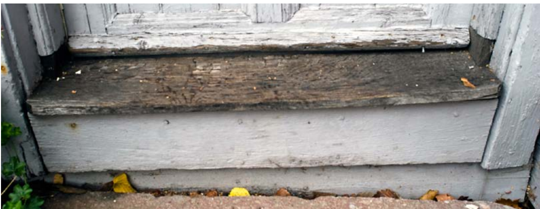
Terskelen er ganske gåen og slipper antagelig vann inn. Bør få et fall utover og døren en lengre og mer effektiv dryppnese. At døren er innadslående er ok om dette forholdet gjøres funksjonelt.
