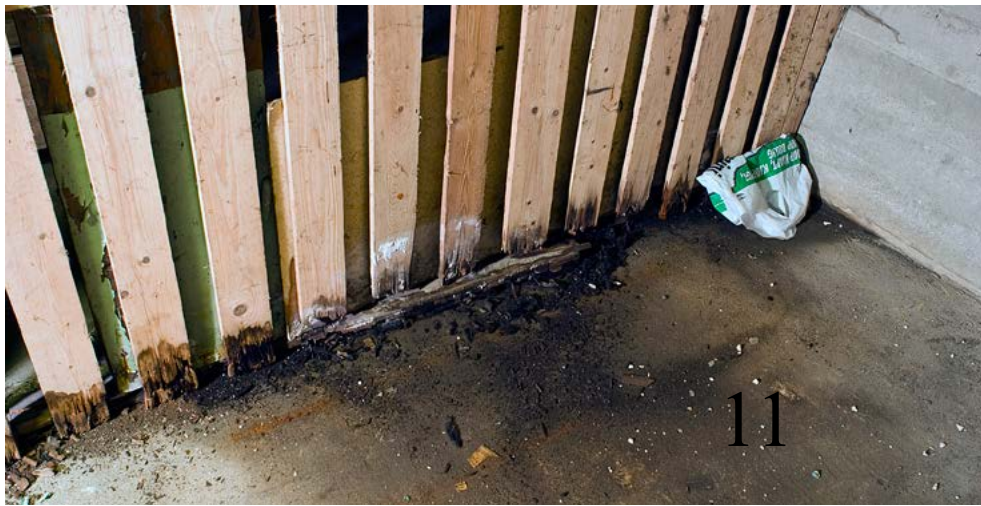
Råteskader i skilleveggen i den yngre kjelleren.
