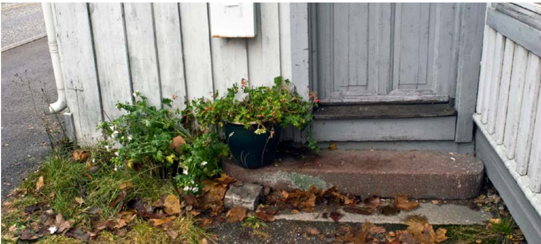
Gammel inngangsdør til trappehusets forbindelse til annen etasjes leilighet. Terreng bør ryddes opp.
