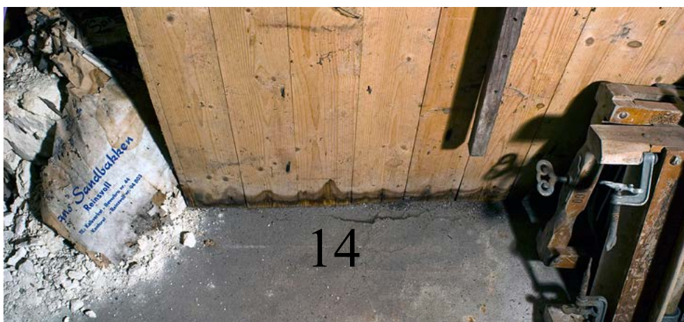
Råteskader i skilleveggen mot det avdelte kjellerrommet i den yngre kjelleren mot sydvest.
